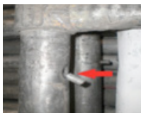
Tetones rotos en laterales
