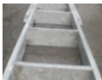
Suciedad en peldaños
