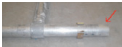
Ausencia de casquillo interior en lateral de barandilla
