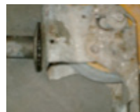
Mal estado del vástago
